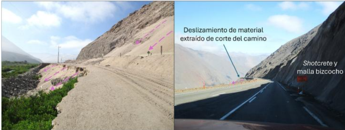
Fig. 40 Deslizamientos que afectan infraestructura y obras antrópicas. Archivo de terreno. Fotografía izquierda: ruta 11, acceso a sector de El Tambo con evidencias de deslizamientos (flechas moradas) de materiales antrópicos sobre canal de regadío (ID_RM 15120207, 392149E; 7965106S). Fotografía derecha: ruta 5 (Panamericana norte) en el acceso a Cuya con evidencia de deslizamientos que afectan berma y calzada (indicado y flecha morada). ID_RM 15150004 (377108E; 7884180S).
