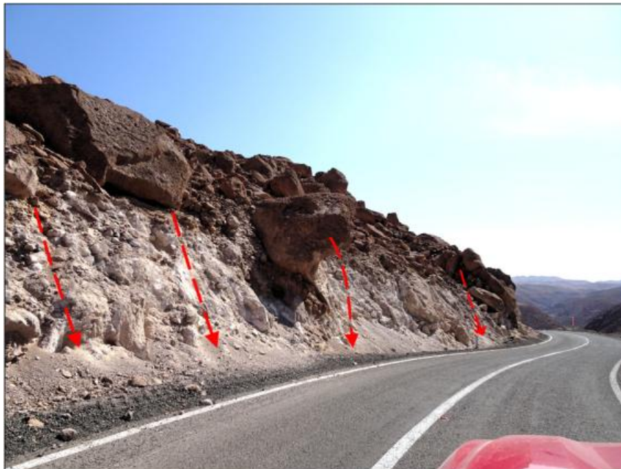
Fig. 35 Ejemplo de caída de rocas en ruta A-331 (esquemmatizada con líneas rojas). Archivo de terreno. ID_RM 15150148 (426826E, 7913492S).
