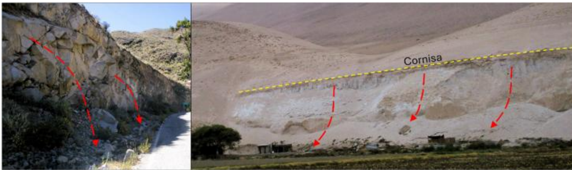
Fig. 7 Ejemplos de caídas de rocas (flechas rocas indican posibles trayectorias) asociadas a distintos tipos litológicos y mecanismos. Archivo de terreno. Fotografía izquierda. Ruta A-31, sector Chapiquiña (coordenadas 441977E; 7968514S). Fotografía derecha: ruta 11 – sector Estación Rosario (coordenadas 379112E; 7964067S). La ubicación espacial del punto de observación de esta y las siguientes fotografías presentadas en el informe se presentan en el ANEXO F.
