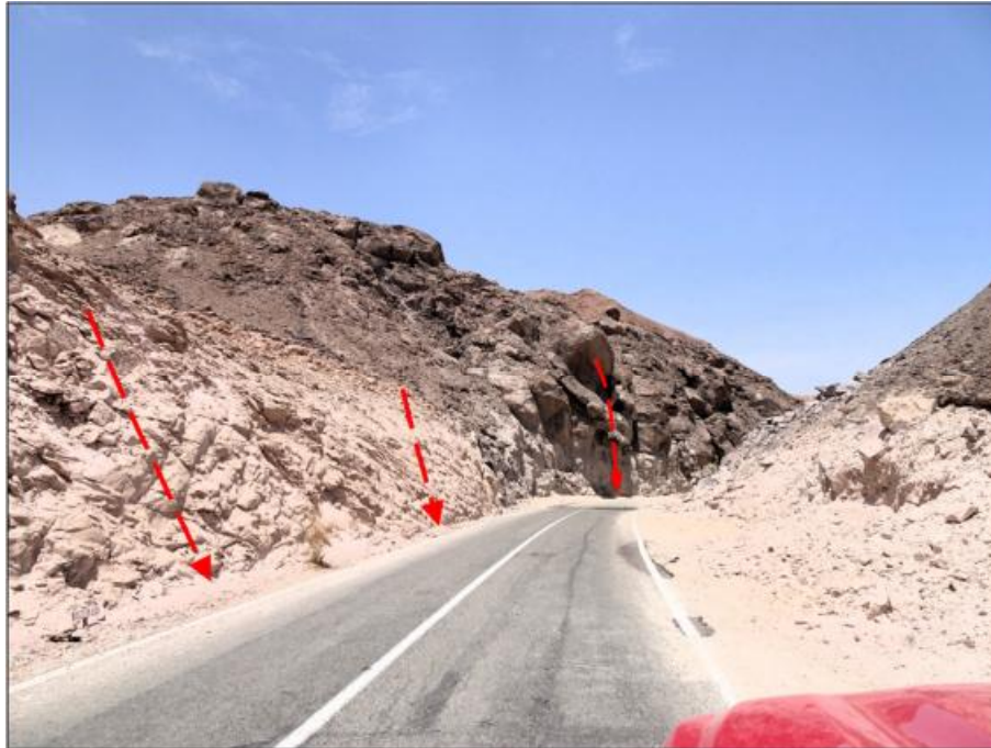
Fig. 34 Ejemplo de caída de rocas en ruta A-35 (esquemmatizada con líneas rojas). Archivo de terreno. ID_RM 15140102 (418338E, 7918113S).
