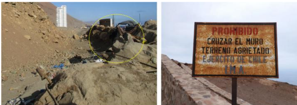
Fig. 71 Fotografía izquierda muestra uso de la zanja del Morro de Arica para pernoctar. Derecha muestra el estado de la actual señalética de la parte superior del Morro que advierte la presencia de terrenos agrietados.
