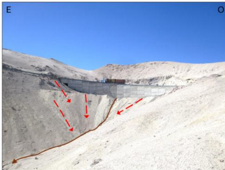
Fig. 100 Remociones en masas en ruta 11, cuesta dirección el Tambo-Zapahuira. Archivo de terreno (las flechas rojas indican la dirección del deslizamiento). Vista inferior de relleno de quebrada con evidencias de arrastre (flecha café) (398523.51 E; 7963305.66 S).
