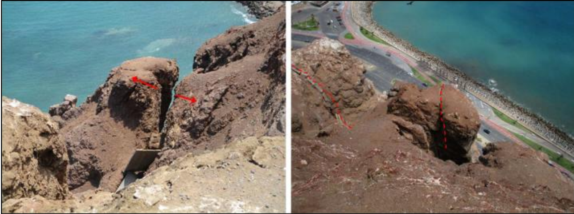
Figura 2-11 Grietas activas en laderas del Morro de Arica
