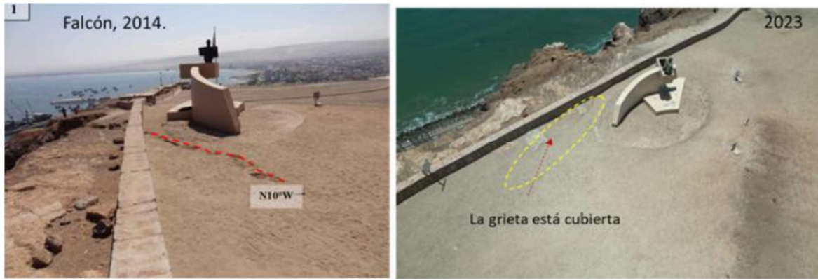
Figura 3-11 Grietas en el Morro de Arica borradas y cubiertas.
